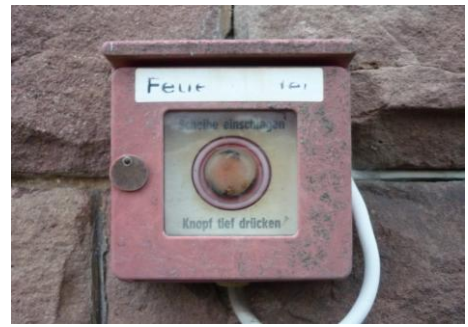
Abbildung 6 - Original Handfeuermelder Schulhaus Mitteltal 2017
